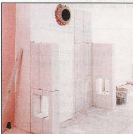
Тыльную часть камина выкладывают у стены так, чтобы дымовая труба была совмещена заподлицо с поверхностью стены.
