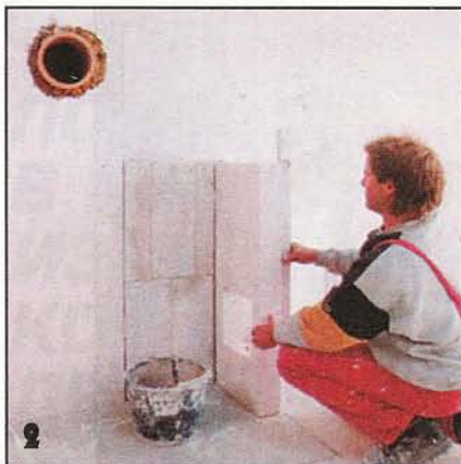
Устанавливаемые вертикально вразбежку блоки крепят специальным клеем. В отверстие позже вставляют решётку для циркуляции воздуха.
