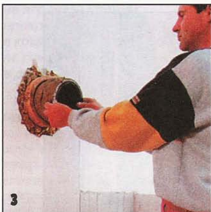
Теперь в стеновой патрон на огнеупорном растворе можно вставить шамотную трубу, разглаживая швы влажной губкой.
